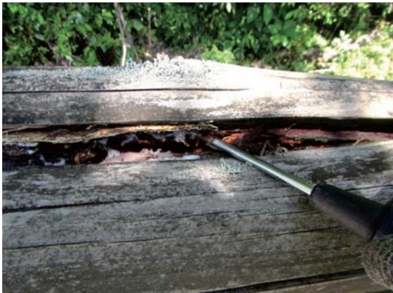
写真－7 被害状況写真（被害度4）
