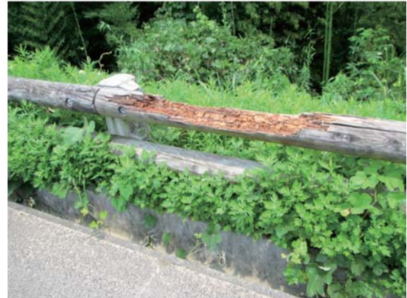
写真－8 被害状況写真（被害度5）
