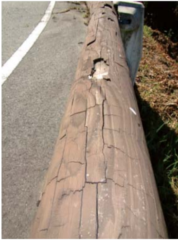
写真－5 被害状況写真（被害度2）
