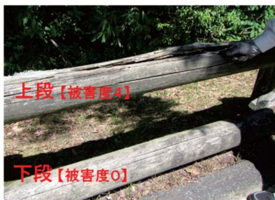
写真-9 腐朽が最上段の横木のみが発生した状況
