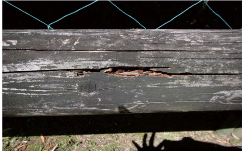
写真－6 被害状況写真（被害度3）
