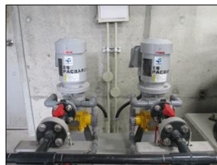
薬品注入ポンプ
