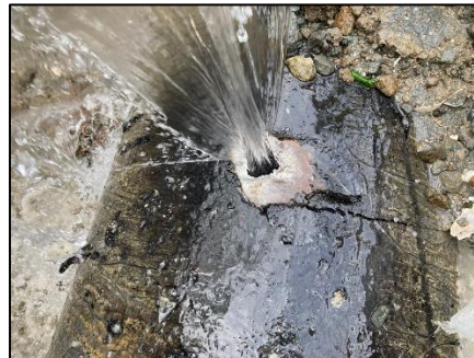
漏水箇所拡大
