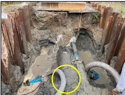
漏水状況(配水本管 φ700)
