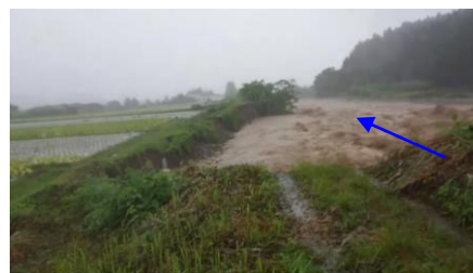
被災状況 (R2. 7月4日時点)
