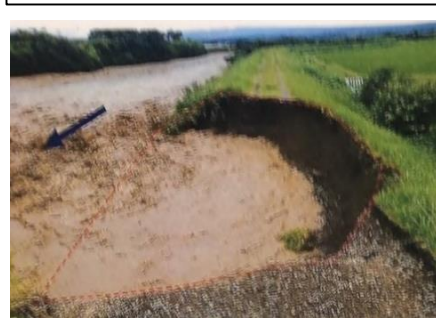
被災状況 (R2. 7月4日時点)
