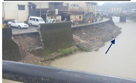
被災状況 (R2. 7月4日時点)
