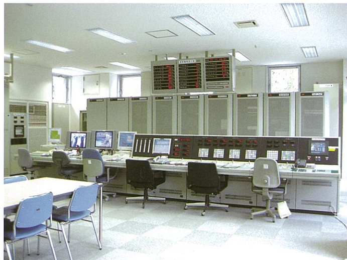
ダム管理用制御処理設備
