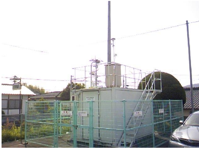
図8 微小粒子状物質自動測定装置（コンテナ屋上）
