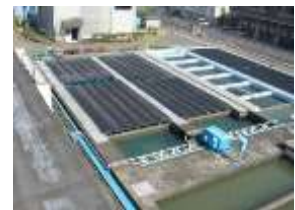
ブロック形成池・沈殿池
