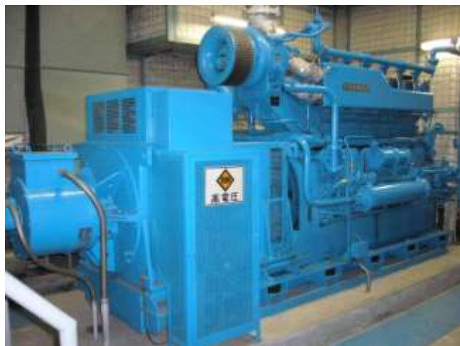
現在の予備発電機(ヤンマー製、まさにエンジン・・・)
