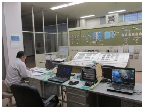
八代工水の頭脳！監視制御室
