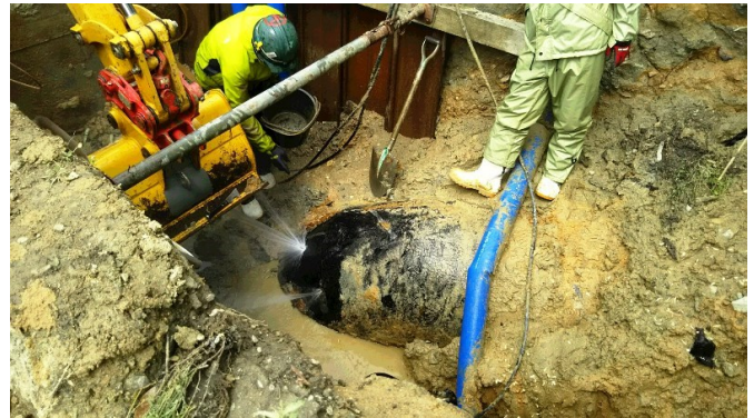
荒尾市金山地区の地中管漏水状況
