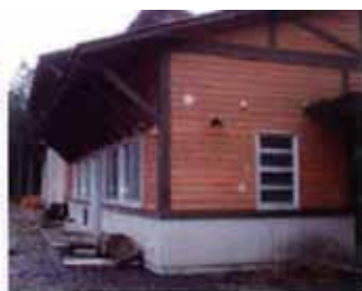
写真4 軒やけらばの出による保護効果の例(栃木県21世紀林業創造の森訓練棟) さらに基礎が高い場合には雨水の跳ねも少なく保護効果がより高まる。
