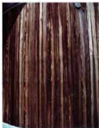
写真1 木製外壁の変色 右側は日当たりや雨降りが多く灰色化している。なお、灰色化した後でも周囲の色やデザインとマッチするよう設計すれば、灰色化の悪影響を持たせることも可能である。
