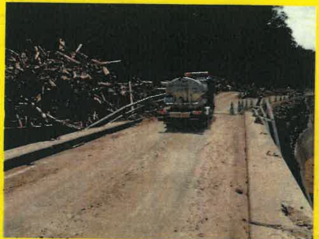
ガードレールがない
