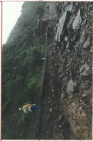
1 工区 被災状況 R2.07.07 (下流側から撮影)
