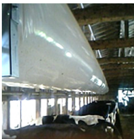
大風量送風ダクト(全農畜産サービス提供)
