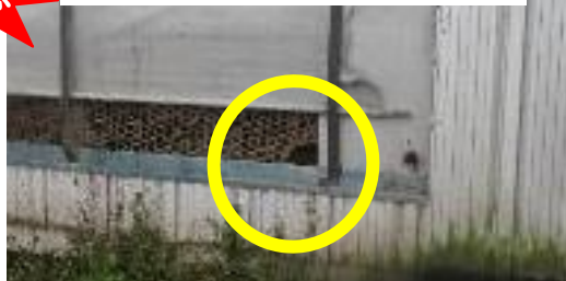
家きん舎側面の金網の破損
