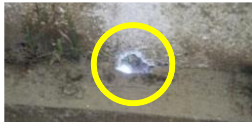
家きん舎壁の破損によりできた隙間
