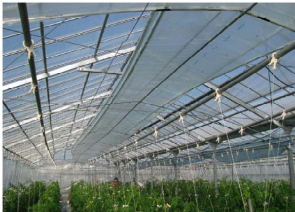
図3 2層カーテンの巻き取り状況
