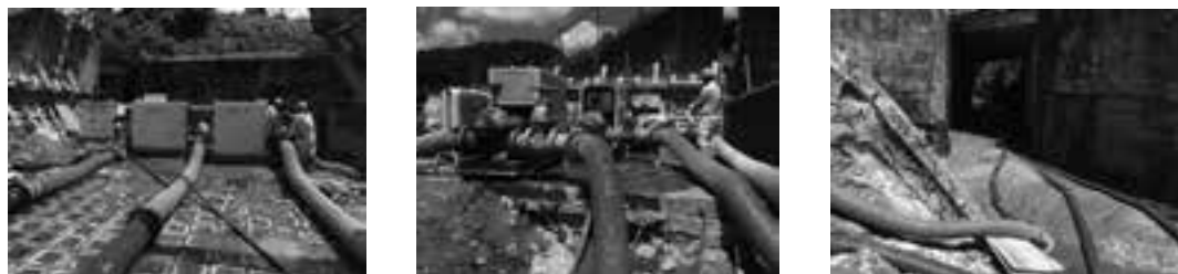
排水ポンプによる強制排水
