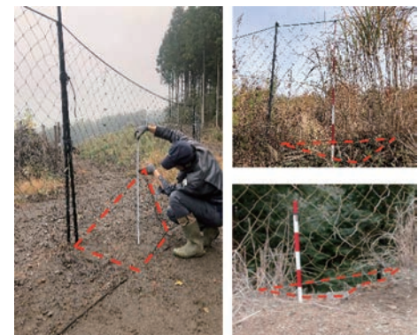
写真左：森林被害防止柵入口部、 写真右上下：地際の隙間
