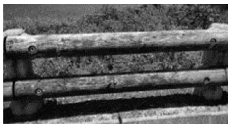
写真-1. 木製ガードレール
