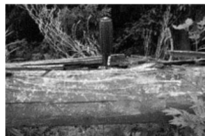
写真-2. 被害程度3の横木
