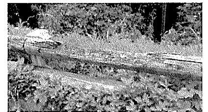
図-1. 劣化が著しく進行した横木
